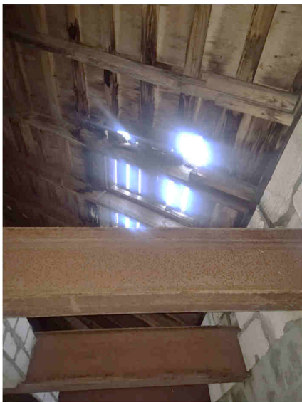
Bojāts jumta segums
